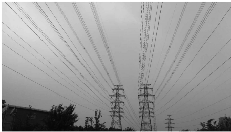
图 10 同塔多回输电线路照片
