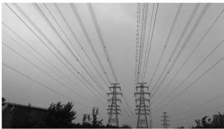
图 10 同塔多回输电线路照片
