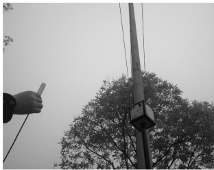
图 8 10 kV输电线路测试现场照片
